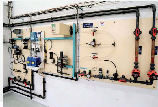
PANOPLIE DE CHLORATION
